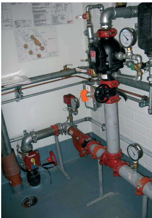
Kuva 11. Sprinklerikeskus on liitetty suoraan yleiseen vesijohtoverkkoon.
